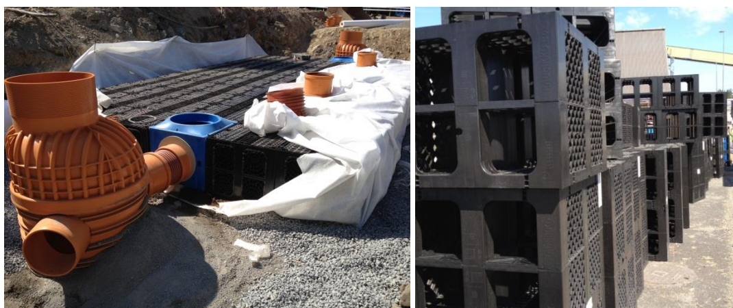
Figur 10. Exempel på dagvattenkassetter.
